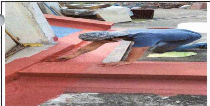
Foto 5: REPARACION DE JUNTA SISMICA, EN MODULO DE SALONES DE DOS EDIFICIOS COMPARTIDO CON JORNADA MATUTINA.
