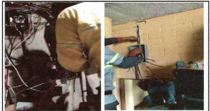
Foto 4: REPARACIÓN DE SISTEMA ELÉCTRICO INSTALACION DE 10 FLIPONES EN TABLEROS + SUSITUCION DE CABLE DE DIFERENTES CALIBRES, EN AREA DE TALLERES.
