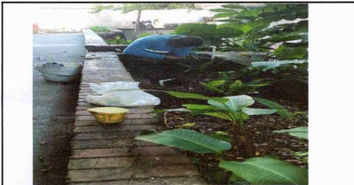
Foto 3: SUSTITUCIÓN DE TUBERÍA POR FUGA DE AGUA EN GRADAS EN JARDINERA COMPARTIDO CON LA JORNADA MATUTINA.
